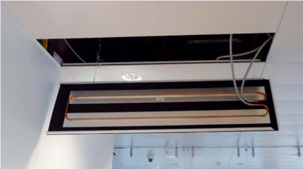
Zugänglichkeit Deckenhohlraum (seilgesicherte Kühldeckenplatte)
