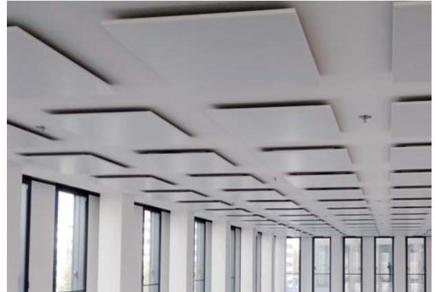
Optimale TAM-Belegung für Heiz-/Kühlleistung sowie Raumakustik
