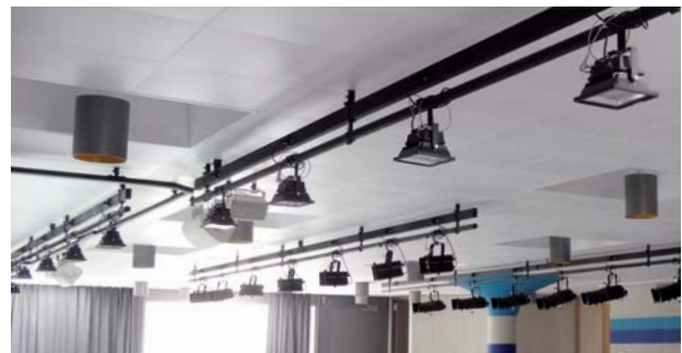
Unsichtbare Lufteinführung, z.B. über Sonoperf Spezialschlitzlochung
